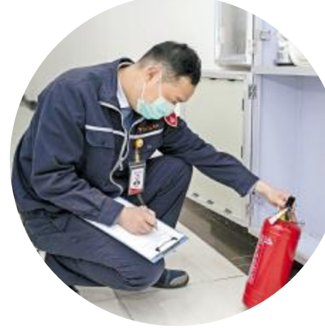
曾凯进行消防栓点检
