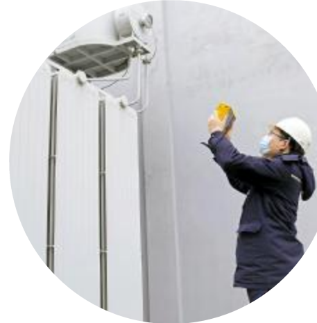
晋建品正在对主变压器接线端进行测温巡检
